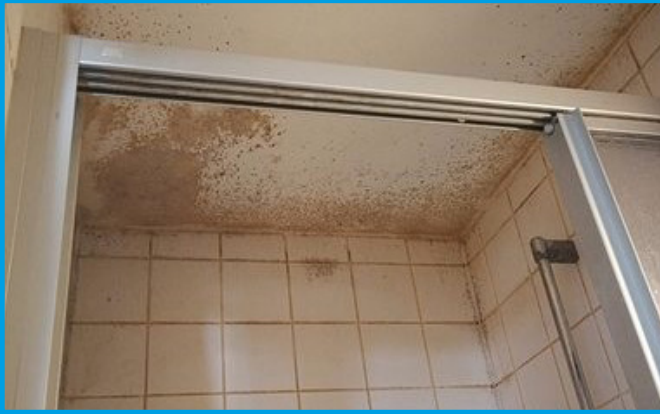
Schimmel in der Dusche einer Flüchtlingsunterkunft
