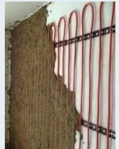
Wandflächenheizung, @Kalk-und Lehmputz
